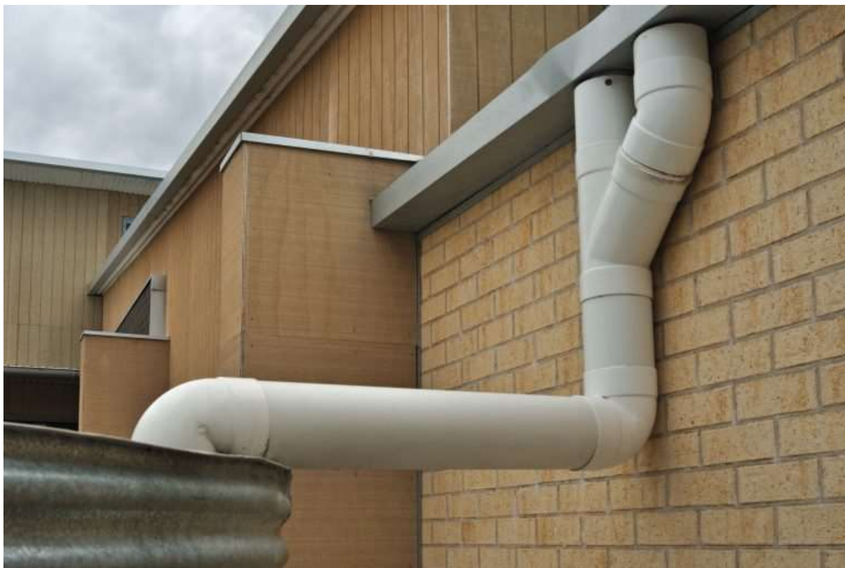
Casa com encanamento para captação de água da chuva
